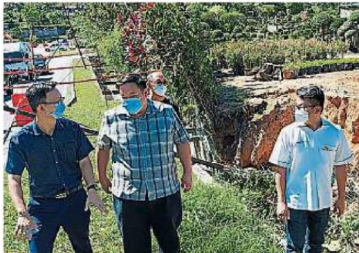
丘钦潮（右起）、官世峰及陈狄源前往了解坍塌现场，受到泥土影响倒地的电话线杆尚未移走。（李景志摄）
