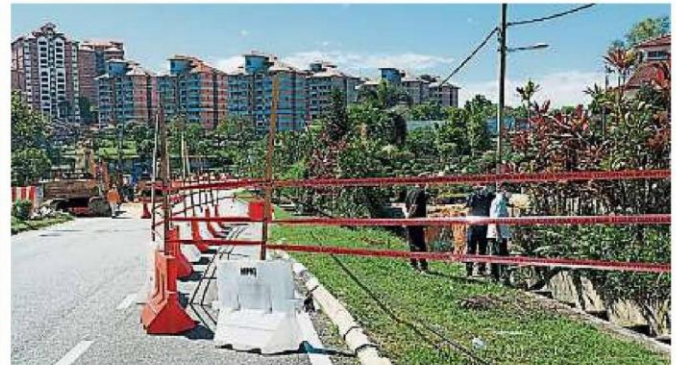
为确保路过车辆安全，加影市议会工程组在坍塌位置围起，禁止民众靠近。（李景志摄）
